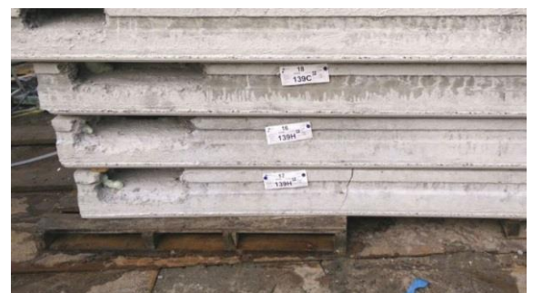
Fout, niet lossen op pallets! (plaat is gebroken)
